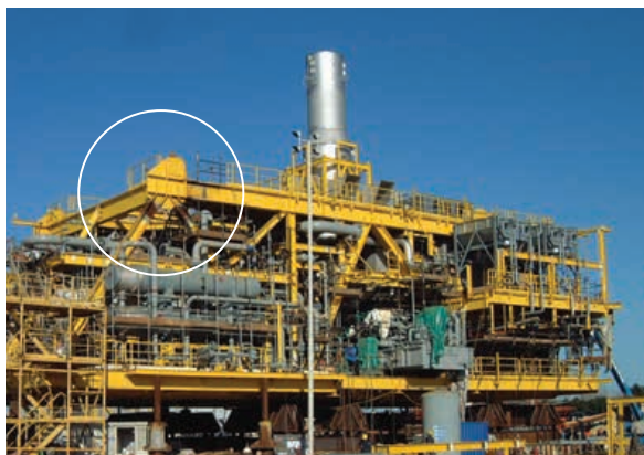
Das nebenstehende Detail der Industrieanlage zeigt die vielfältigen Möglichkeiten der Lindapter Produktpalette.
